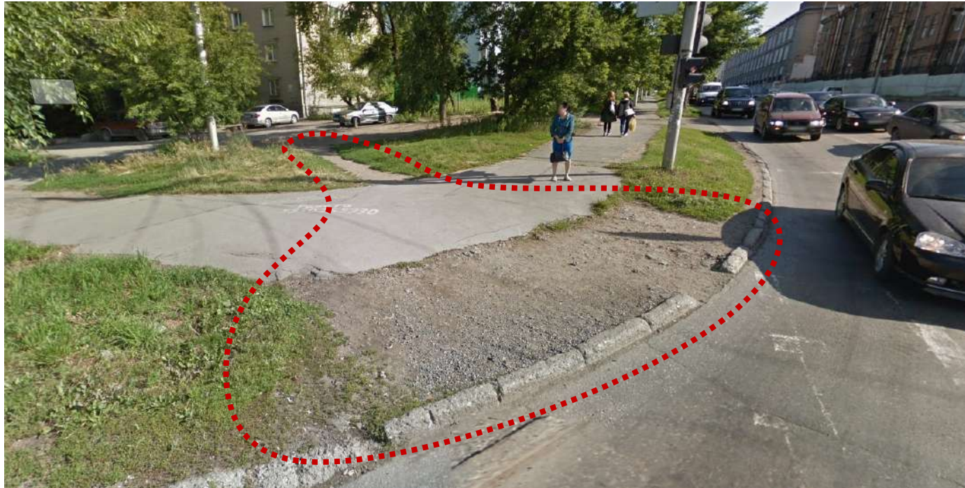
Одной из главных проблем на транзитных путях является отсутствие покрытия.
